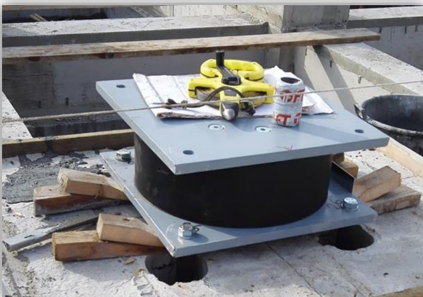
- Ricostruzione Edifici Ater L'Aquila - isolatori antisismici - High Damping Rubber Blarting -
