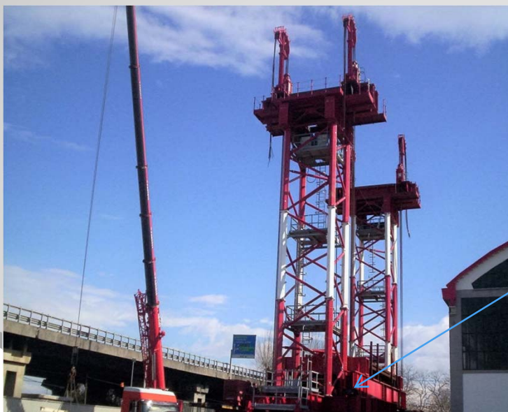
Impianto sollevamento piattaforme Petrolifere
